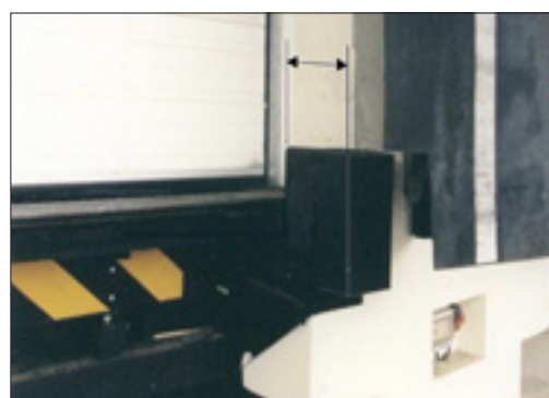
Photo 3.5 Vue sur butoirs assurant un espace de 500 mm devant le mur du quai et devant la rampe ajustable en position de repli.
