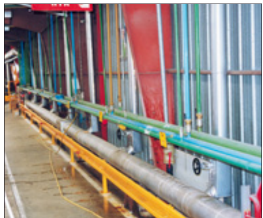
Photo 5.2 Fluides. Système de couleur pour le repérage des circuits des différents fluides.
