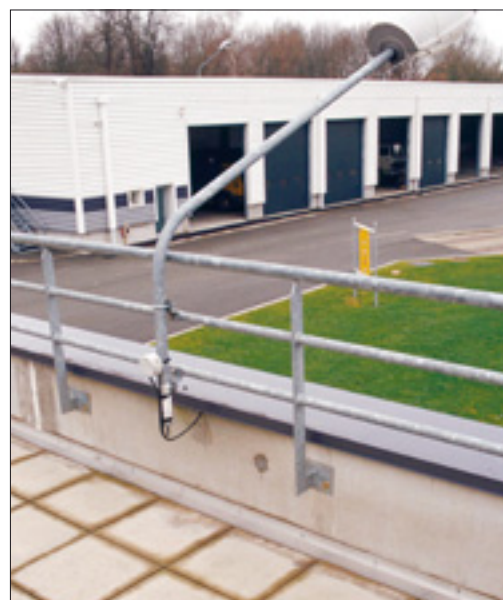
Photo 5.1 Luminaire pivotant facilitant le remplacement d'ampoule.
